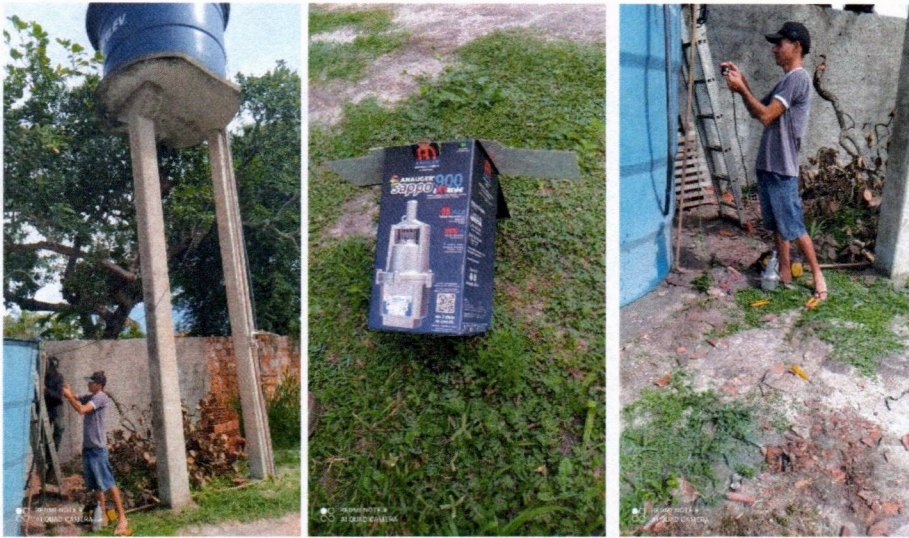
Imagem 05 – Desmontagem do equipamento submerso; conj. Moto-bomba submersa; montagem e instalação de conjunto moto-bomba submersível (eixo vertical) em poços tubulares; abraçadeira de nylon para amarração de cabos e teste de produção com bomba; distribuição de rede de água; instalação de reservatório.
