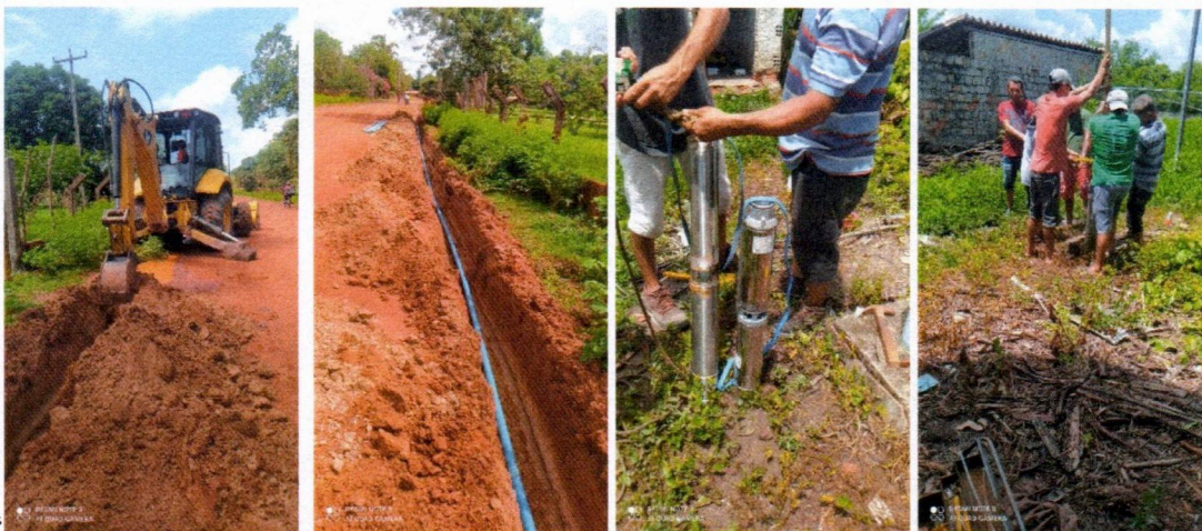
Imagem 03 – Desmontagem do equipamento submerso; conj. Moto-bomba submersa; montagem e instalação de conjunto moto-bomba submersível (eixo vertical) em poços tubulares; abraçadeira de nylon para amarração de cabos e teste de produção com bomba; instalação de quadro.
