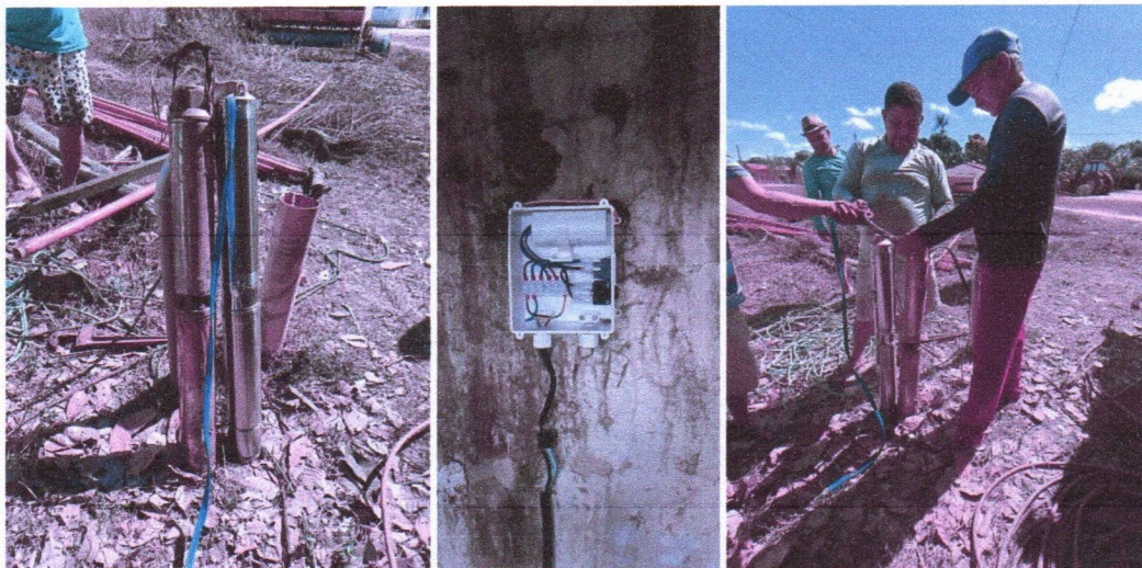
Imagem 03 – Desmontagem do equipamento submerso; conj. Moto-bomba submersa; montagem e instalação de conjunto moto-bomba submersível (eixo vertical) em poços tubulares; abraçadeira de nylon para amarração de cabos e teste de produção com bomba; instalação de quadro.
