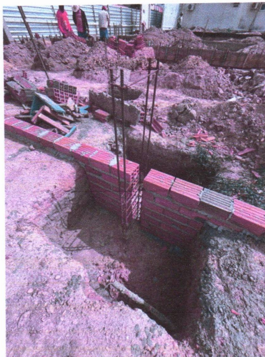
Imagem 5 – Execução do embasamento em alvenaria, sapatas e ferragens de vigas e pilares;
