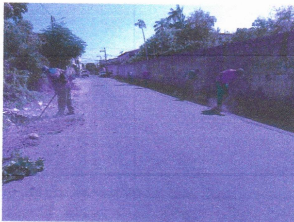
Imagem 01 – equipe realizando limpeza de ruas (varrição e remoção de entulhos), limpeza manual de vegetação com roçadeira em vias públicas e bota fora em caminhão basculante
