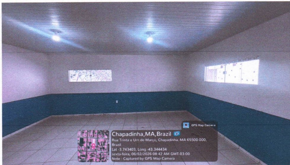
Imagem 3 – Pintura interna das salas, instalação do forro de pvc e instalação da esquadrias.
