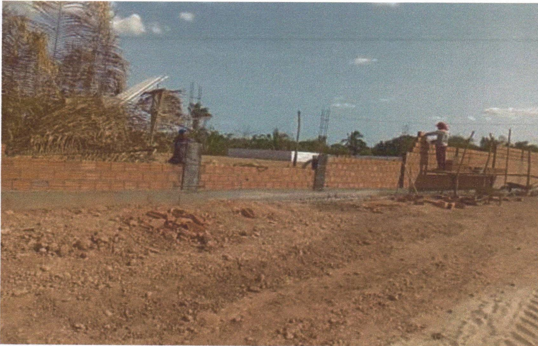
Figura 20 – CONSTRUÇÃO DE UMA UNIDADE ESCOLAR - Medição 01 – Levantamento de alvenaria estrutural — início da elevação das paredes.
