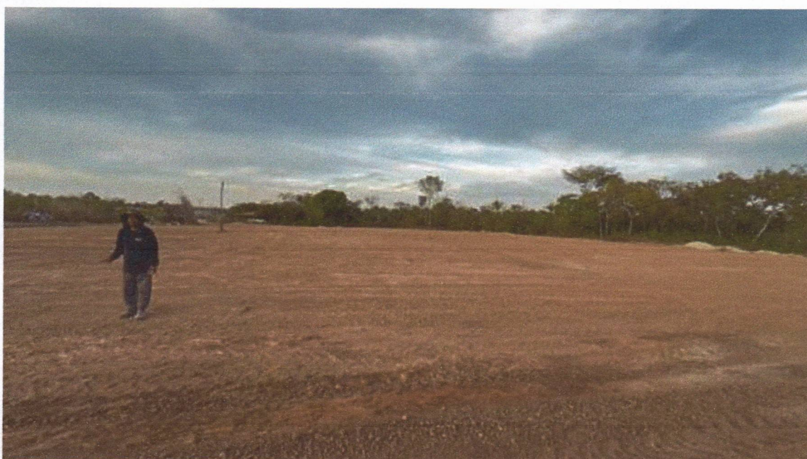
Figura 2 – CONSTRUÇÃO DE UMA UNIDADE ESCOLAR - Medição 01 – Finalização da etapa de terraplenagem, demonstrando uniformidade da compactação do solo.
