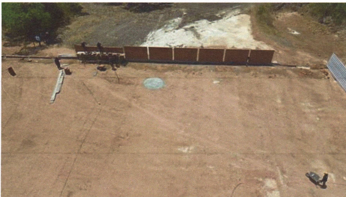
Figura 27 – CONSTRUÇÃO DE UMA UNIDADE ESCOLAR - Medição 01 – Execução de alvenaria de vedação no perímetro da obra sobre baldrame concretado.
