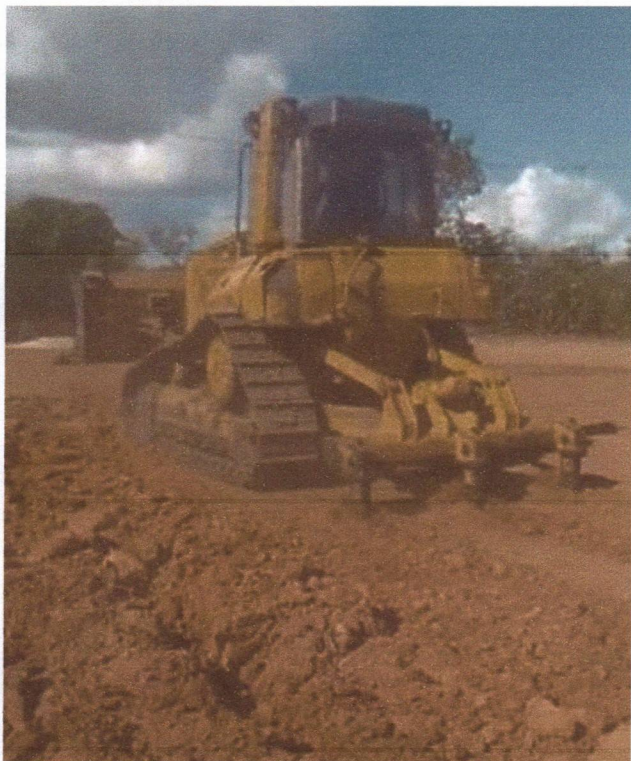
Figura 17 – CONSTRUÇÃO DE UMA UNIDADE ESCOLAR - Medição 01 – Quebra de camadas compactadas e preparação para fundação.
