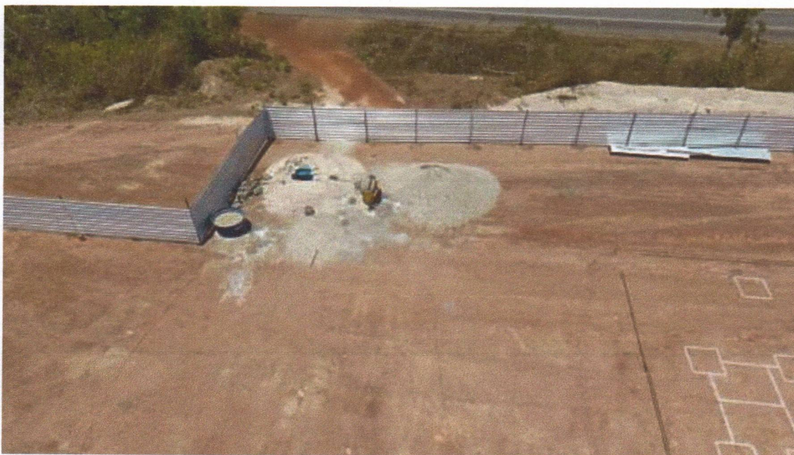
Figura 26 – CONSTRUÇÃO DE UMA UNIDADE ESCOLAR - Medição 01 – Visão aérea do canteiro de obras com montagem de tapume metálico.
